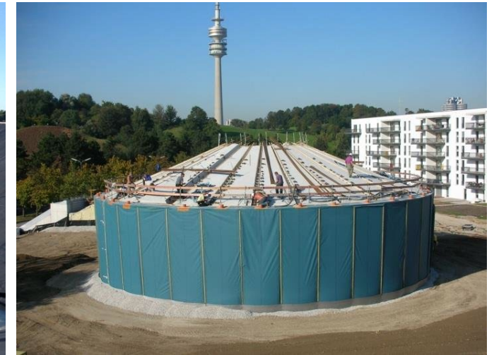
Tank TES in Munich.
