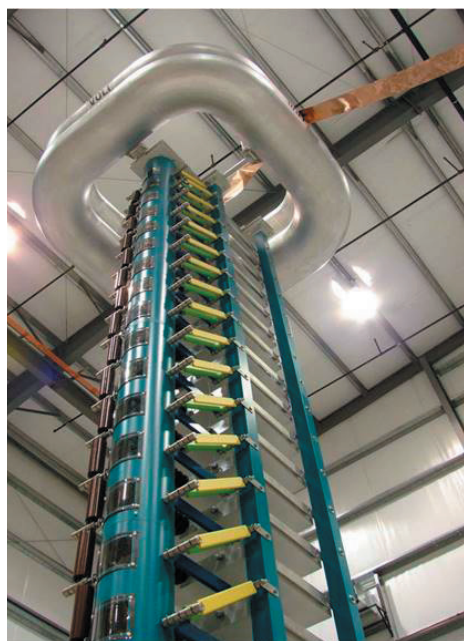
FIGURA 1. Gerador de alta tensão (Gerador de Marx de 2,4 MV) operado pela NTS.
