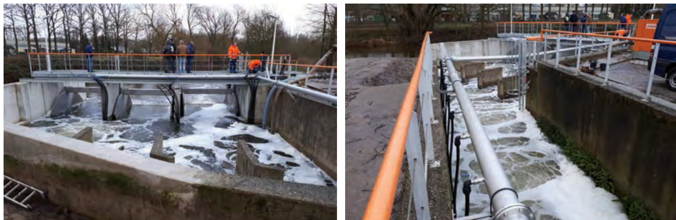
图 7. 工作状态下的埃因霍温污水处理厂的曝气通道, 它有效增加了注入多梅尔河河水中的含氧量。左: 曝气通道出口处的可调出水堰。右: 从曝气通道的入口观察曝气通道。
